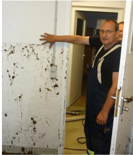
Abbildung 25: Hochwasserschaden in Wohnhaus, Ditzingen 2010 (Quelle: Feuerwehr Ditzingen)
