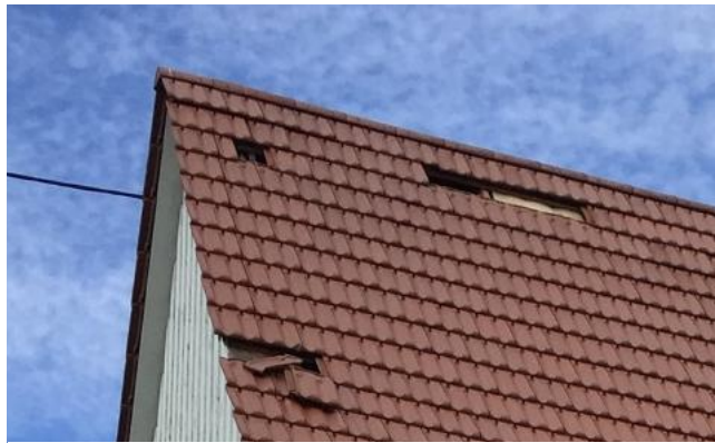
Abbildung 27: Sturmschaden, 2015 (Quelle: Feuerwehr Ditzingen)
