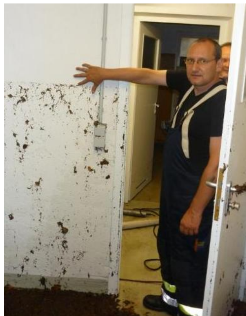
Abbildung 25: Hochwasserschaden in Wohnhaus, Ditzingen 2010 (Quelle: Feuerwehr Ditzingen)
