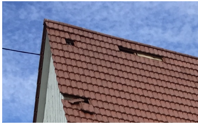
! Abbildung 27: Sturmschaden, 2015 (Quelle: Feuerwehr Ditzingen)
